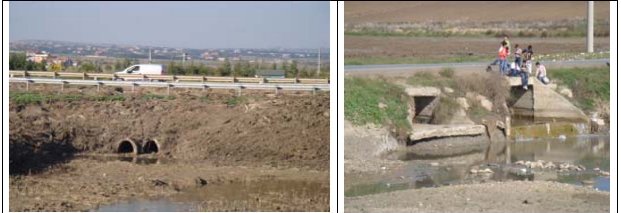
Foto 3. Selimpaşa-Silivri arası doğal akım yönünü keserek set oluşturan karayolu dolguları.
