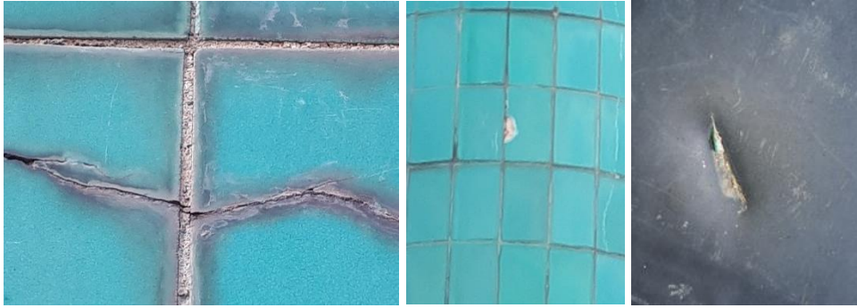
Şekil 8. Kubbe çinilerini birbirine bağlayan harçlarda oluşan çözünme. Şekil 9. Çini parçadaki yüzeyde görülen kopma. Şekil 10. Kurşun sacın kopan çini parçası tarafından delinmesi.
